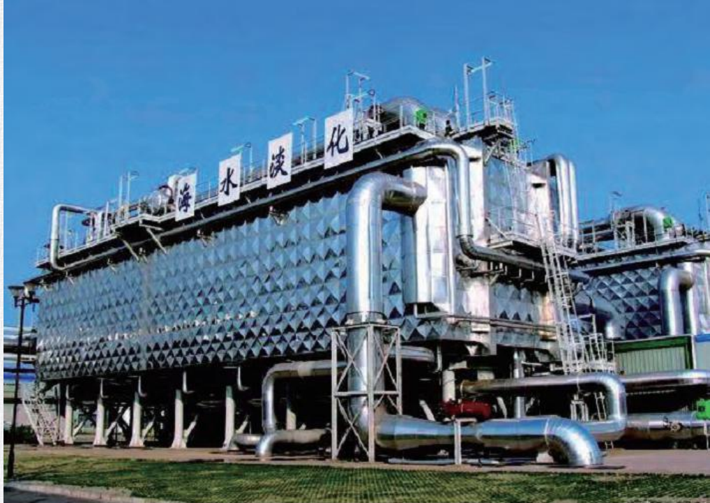
首钢京唐海水淡化工程
