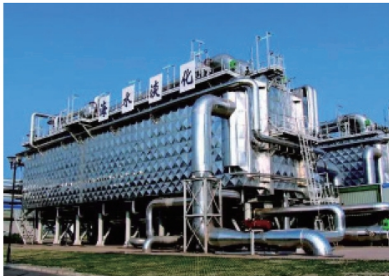
首钢京唐海水淡化工程
